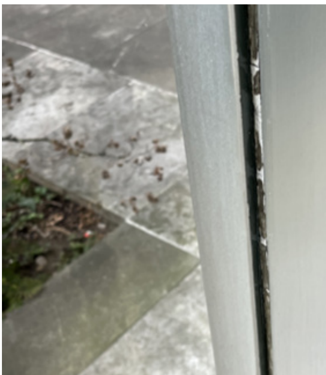
Abbildung 9 (links): Diese Glasscheibe ist in einem Aluminiumrahmen mit Kitt eingebaut. Da Kitt kein elastisches Dichtungsmaterial ist und über die Jahre hart wird, ist ein Ausbau der Glasscheiben nur sehr schwer möglich. Daher besteht hier nur die Möglichkeit, Glas aus dem Rahmen zu klopfen. Damit ist eine Wiederverwendung direkt als Flachglas nicht möglich. Es besteht aber die Möglichkeit die Scherben zu sammeln und durch kontrolliertes Recycling diese der Floatglasherstellung wieder zuzuführen.
