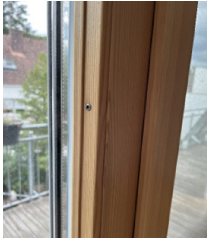
Abbildung 11 (oben): Es handelt sich um ein Fenster neueren Datums, bei dem sich die Scheibe mit hoher Wahrscheinlichkeit, aufgrund der intakten und zugänglichen Schrauben und des Einbaus mit elastischem Dichtstoff, ausbauen lassen wird. Solche lösbaren Konstruktionen sollten bevorzugt werden, da sie in künftigen Bewertungen der Kreislauffähigkeit der Bauprodukte günstiger abschneiden werden.
